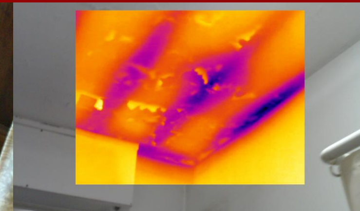
Struttura muraria e muffa
